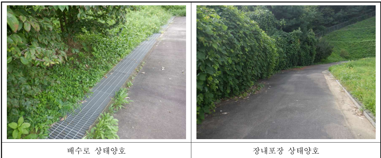
【사진 3.8】 기타 부대시설 손상사진
