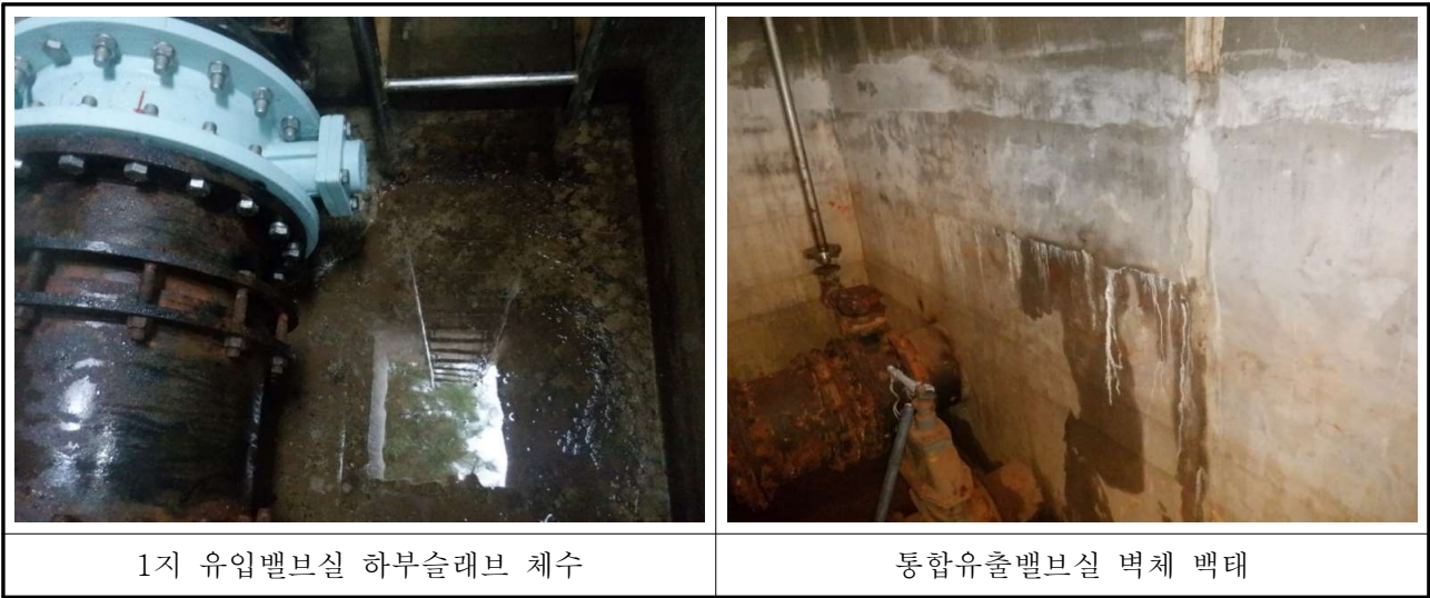
【사진 3.4】 유입 · 유출 밸브실, 유량계실 손상사진 (계속)
