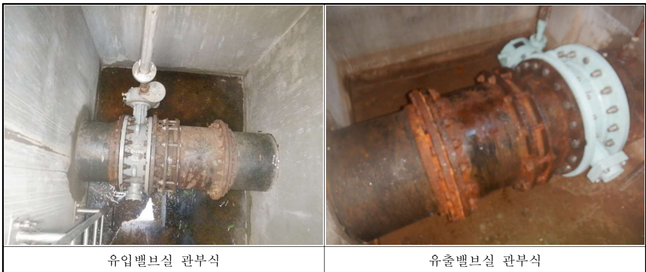
【사진 3.6】 기전설비 손상사진
